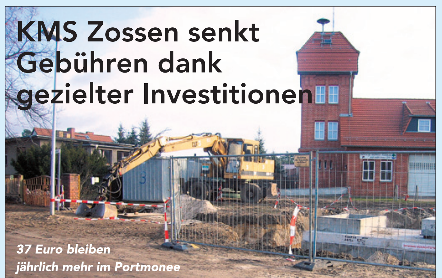
37 Euro bleiben jährlich mehr im Portmonee In der Gemeinde Mellensee werden insgesamt 377 Grundstücke an den Abwasserkanal angeschlossen.
